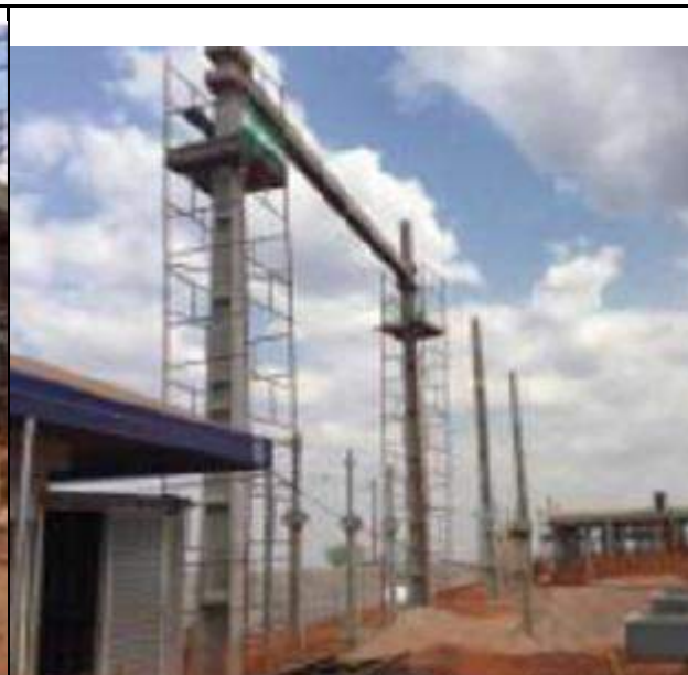
Foto 6: Suporte para descida de cabos da LD
