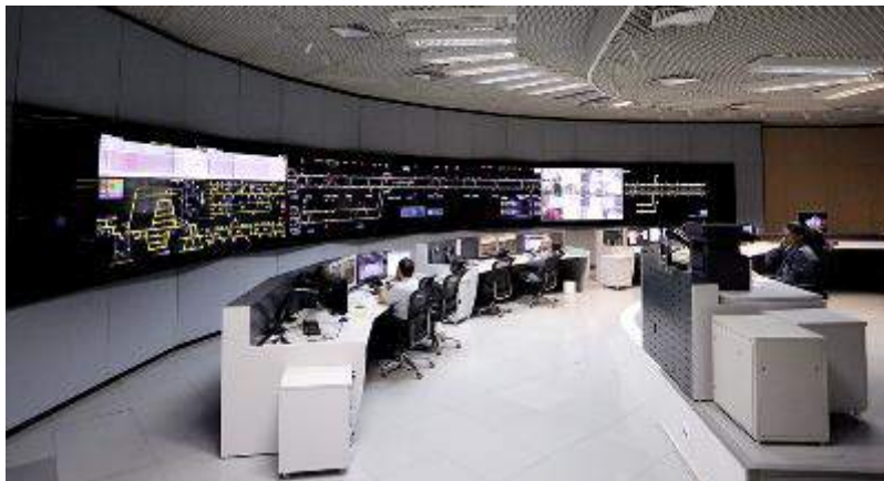
Figura 15 - Modernização do Centro de Controle Operacional - CCO
