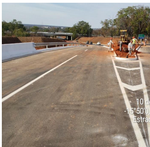
Pavimentação asfáltica e sinalização horizontal realizada para liberação do trânsito no Viaduto 63 - ESPM
