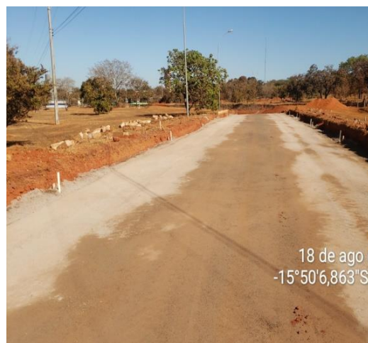
Conclusão da base em CCR (concreto compactado a rolo) do Eixo 64 - ESPM
