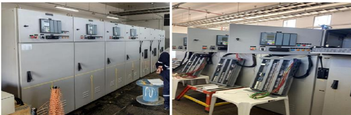
Painéis de Energia
