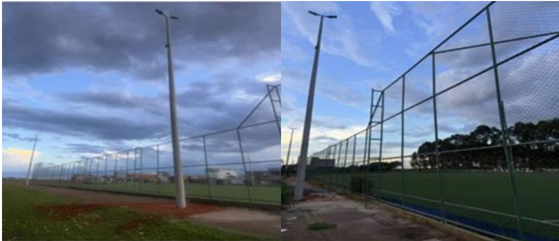
Implantação de Iluminação Pública no Campo Sintético da QS 20 - Riacho Fundo II - Ampliar pontos de Iluminação Pública no DF:
