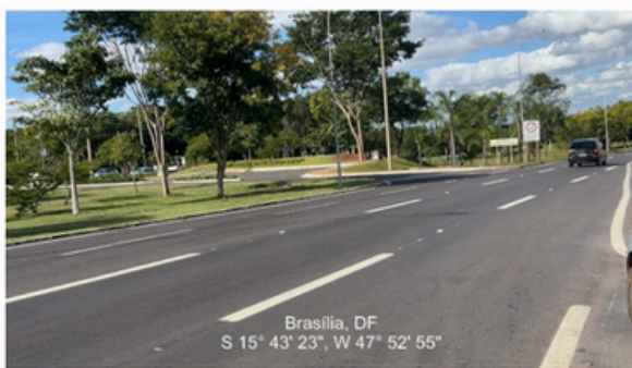
DF- 009 - Sinalização/Tacha refletiva.
