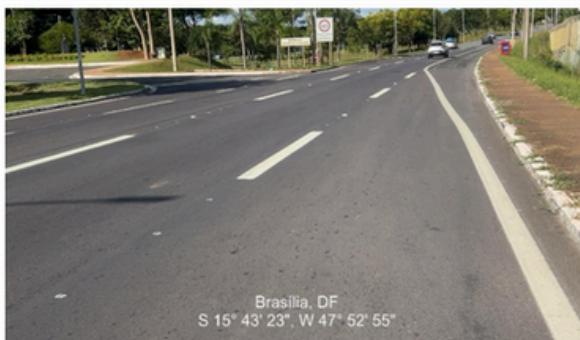
DF- 009 - Sinalização/Tacha refletiva.
