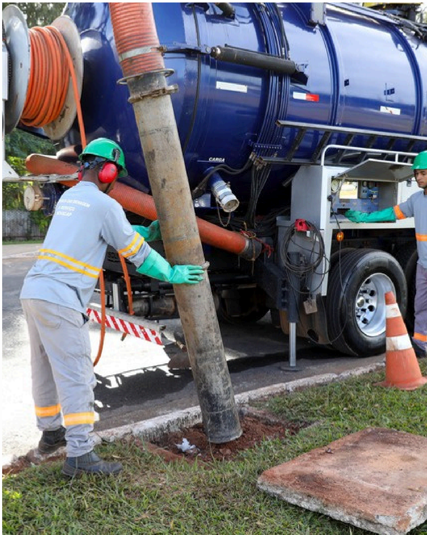
GDF moderniza limpeza da rede pluvial e retira 192 mil toneladas de resíduos. Agência Brasília.
