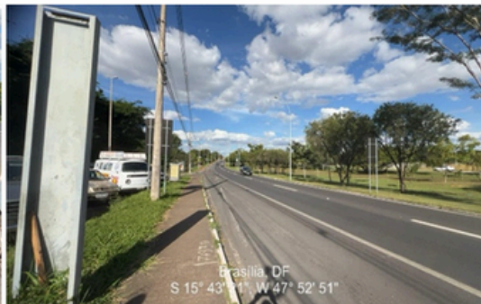
DF- 009 - Sinalização/Tacha refletiva.
