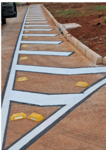
Via de acesso ao Terminal da Asa Sul (TAS) - Sinalização/Tachão refletivo.
