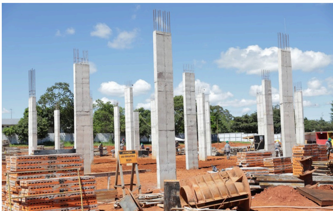
Obras do Hospital do Recanto das Emas chegam à segunda etapa com 96% da fundação concluída. Agência Brasília (02/04/2026).
